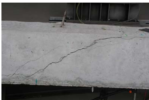
Rysunek 3: Zniszczenie belek P1 do P3
