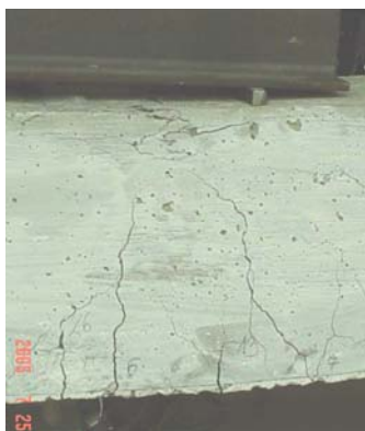
Rysunek 2: Zniszczenie belek B1 do B12
